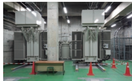
在此次工程中更新的超高压变压器为7,500kVA×2台。将分别设置在Sunpiaza和dUo中的电力接收系统合并，安装在Sunpiaza中。从更新后的超高压设备向dUo供电。
