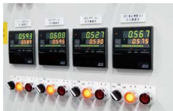
管末の圧力が表示されるエア減圧制御盤。厳格な制御には山武の指示調節計SDC40が使用されています
