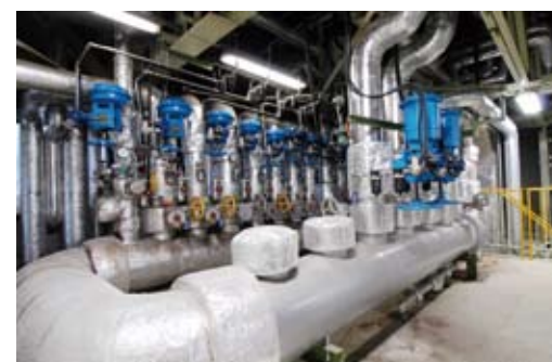
蒸気のループに取り付けられたFloWing。圧力制御により蒸気でも大きな省エネ効果を上げることができます。2005年の5月に導入し、近々投資分が回収できる見込とのこと
