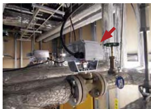
機械室にあるインテリジェントコンポのバルブ
