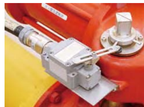
今回のアプリケーションには含まれないが、ガス緊急遮断弁にも山武製のスイッチが使われている
