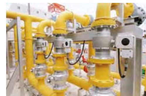
麒麟ビール岡山工場では合計4台のCMPが併置され、配管ごとに計測を行っている。CMPは縦と横のどちら向きでも設置でき、施工性が高いのも特徴
