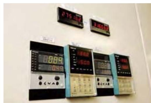
冷温水の温度制御を管理するデジトロニック（20年前に導入）と新たに設置したデジタル指示調節計 SDC
