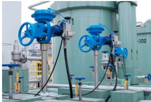
マイナス 162℃に冷却された LNG を制御している圧力調節弁
