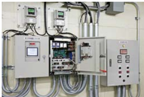
取引用の熱量計盤（左）と冷水遮断弁操作盤（右）。熱量計盤では、熱量演算や流量計測などのデータ蓄積のほか、センターと無線で通信を行っている
