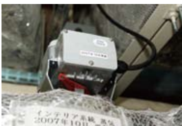
蒸気の制御に使用されているインテリジェントコンボ。アクティブル電動2方弁
