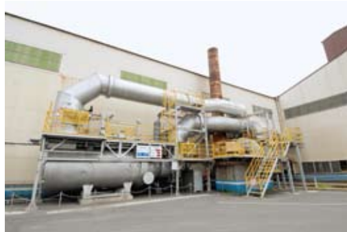
小型圧延加熱炉に設置した廃熱回収ボイラ
