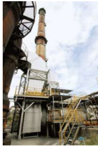
分塊均熱炉・1号連続鋳造用加熱炉の集合煙道に設置した世界最大級の大さを誇る廃熱回収ボイラ
