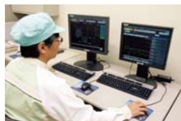
計器室に設置されたオープン・オートメーション・システムIndustrial-DEO
