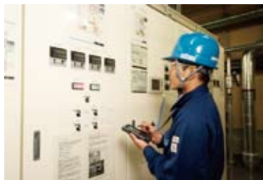
PlantWalker-PTのモバイル端末を使用して、点検作業を効率化
