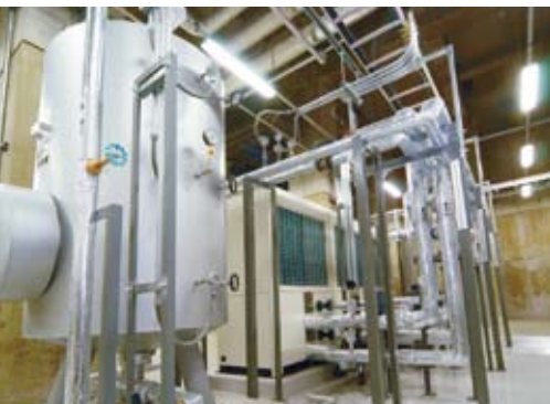
エネルギーセンターに設置されたecoマルチヒートポンプと貯湯槽。空調用熱源の冷水還水と水道水で熱交換を行い、冷水還水から熱を奪うことで冷凍機のエネルギーを削減するとともに、冷水還水から熱で水道水を温め、蒸気製造用ボイラのエネルギー削減を実現する。
