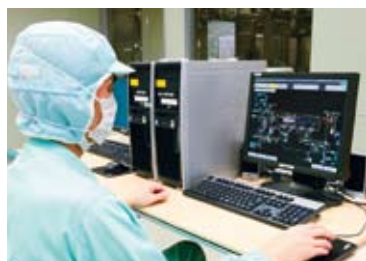
工場内の中央操作室に設置されたIndustrial-DEO/MESの監視端末。ここから、各生産ラインの生産状況を確認し、監視・制御を行っている。
