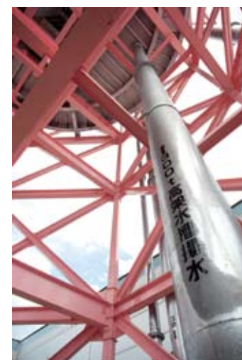
高架水槽下の配管。
