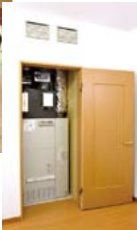
きくばり ecsシリーズの機械室。0.5畳とコンパクト
