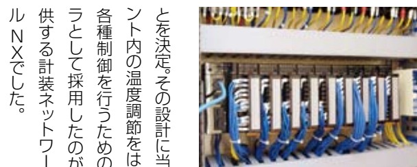
植物工場実験棟内の制御盤に設置された計装ネットワークモジュール NX。実験棟内の温度、湿度などの環境情報を収集し、汎用 LAN ケーブルで中央監視システムと通信を行う。
