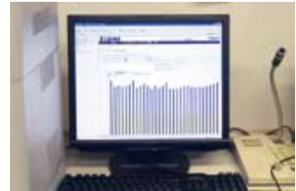
監視室に設置されているsavic-net FXビルマネジメントシステム(BMS)。施設内のエネルギーの消費実態や設備機器の運転・稼働状況などを可視化する仕組みを提供。運用にかかわる省エネルギーの実現を支援している。
