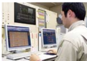
水族館（アクアミュージアム）の監視室に設置されたsavic-net FX。水族館に加え、ショッピングモールの空調や電気、照明などの監視が行えるようになっている。
