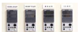
実験棟内の湿度を計測している室内型湿度センサ ネオスタット(上)と、室内温度、CO 2 濃度、溶液温度を制御するデジタル指示調節計 SDC25(下)。
