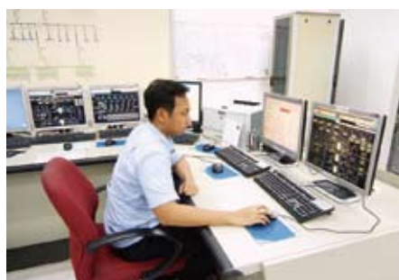
監視室に設置されたHarmonas-DEO。施設内の冷凍機をはじめとする機器の監視・制御がここで一元的に行えるようになっている。
