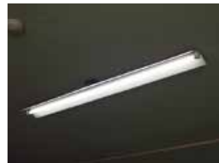
安定器を備えた高効率器具に更新された駐車場の照明。
