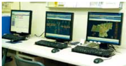
旭町地区(新潟大学病院)を管理しているアズビルの建物管理システム savics-net™FX。管理している電力情報をENEOPTpersサーバーに送信している。
