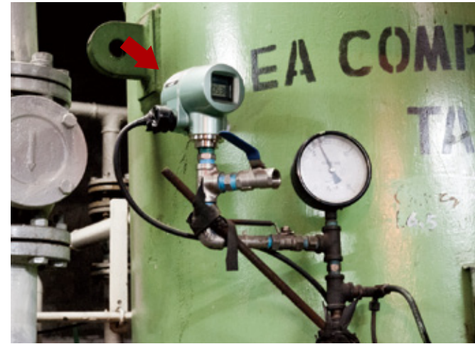
コンプレッサでつくられた圧縮空気は一時的にエアーサージタンクにためられる。圧力センサ Bravolight™ (ブラボライト) でタンク内の圧力を計測し、製造ライン側の需要量に応じてコンプレッサの台数制御を行う。
