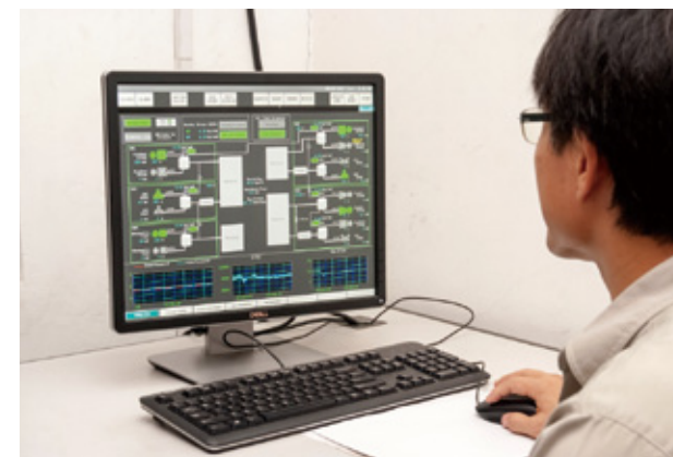
中央監視室に設置されているHarmonas-DEO。
