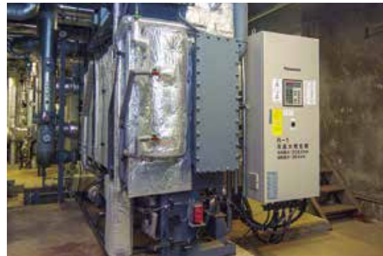
冷温水発生機は、重油焚（だ）き、ガス焚きの2種類が導入されており、それぞれのエネルギー単価に応じて稼働する設備を決定し最適運用が図られている。（写真は重油焚き）
