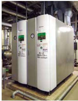
蒸気ボイラも重油焚（だ）き、ガス焚きの2種類が導入されている。（写真はガス焚き）
