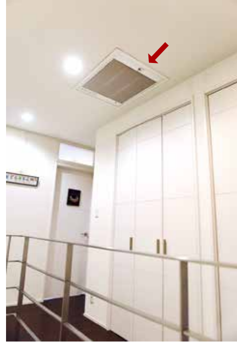
2階踊り場の天井に設置された電子式エアクリーナ。屋内を回った空気が空気清浄機である電子式エアクリーナを経て空調機に戻る。これを1時間に最大で3～5回繰り返す。
