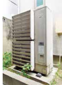
屋外の裏庭に設置された室外機。家屋全体の冷暖房を担う能力を備える。
