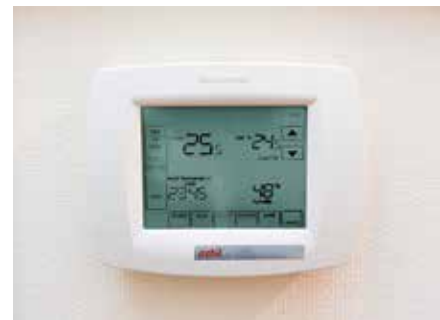
全館空調システムの冷暖房を制御するリモートコントローラ。2階のキッチンスペース脇に設置されている。
