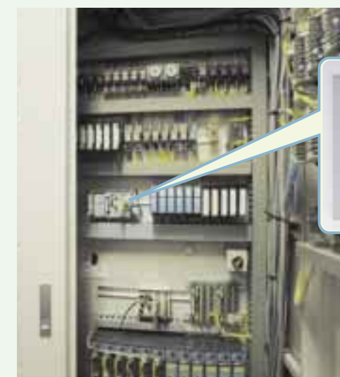
計測標準室に設置した制御盤
