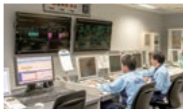
中央冷暖房所の監視室に設置された高度情報統合生産システム Advanced-PS™とU-OPT
