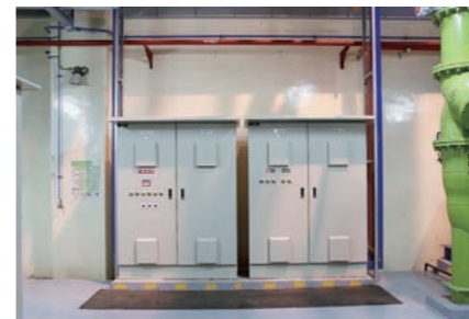
安装在装置内的新控制盘，盘内设有各种控制制冷机、水泵和其它设备的控制器。
