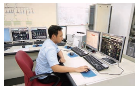
安装在监控室中的Harmonas-DEO对装置中的制冷机及其他设备进行中央监控
