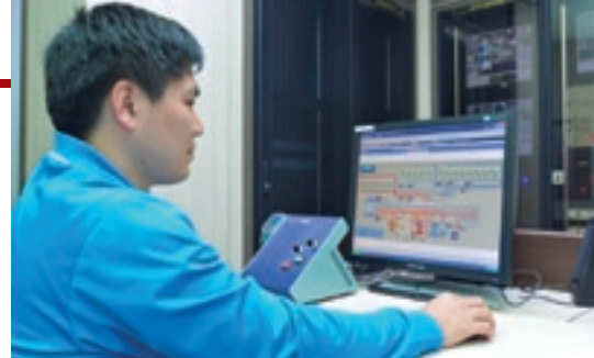
安装在中央监控室中的 savic-net FX 监控终端。实现了对于展示水箱中水温等的集中监控。
