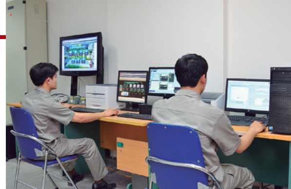
安装有savic-net FX的监控室,在这里可以集中监控设施内的各种设备。
