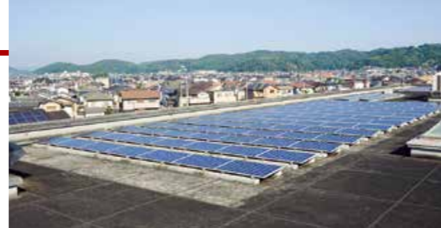
安装在Life Park Kurashiki屋顶的太阳能板。引进太阳能发电也是此次ESCO事业的重点措施之一。
