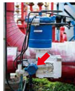
安装在用于纯碱电解设备氢压力调节的阿自倍尔阀门上的智能阀门定位器。
