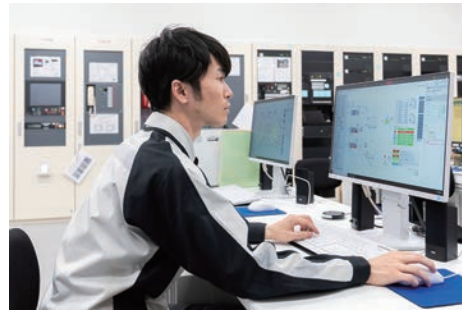
安装在大楼消防中心的 savic-net G5 监视终端。
