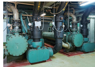
利用设置在热源机房的制冷机制取空调用冷水。通过引进BEMS，按时间表执行启停和台数控制。
