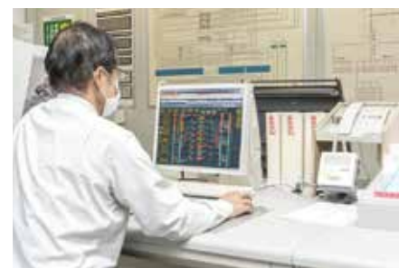
2018年更新的阿自倍尔的楼宇管理系统。对整个设施的运用状况进行统一管理。
