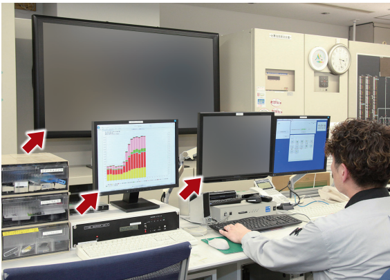
安装在中央监视室的savic-net FX（前中）的空调平面图和savic-net FX楼宇管理系统（BMS）（前左）的电量图表的监视器画面。通过savic-net FX监视空调的控制状态，通过BMS进行设备的台帐管理和能源管理。大型显示器可显示设备管理人员希望共享的信息等。
