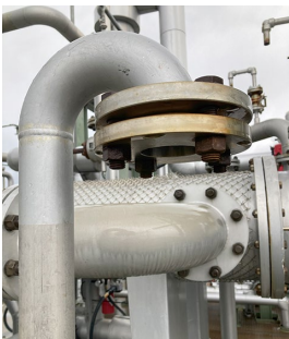
设备通风口（进气口、排气口）。在 FS 中，BiG EYES 比操作员提前约 8 天检测到由于通风口上安装金属网过滤器堵塞所引发的工艺过程反应异常
