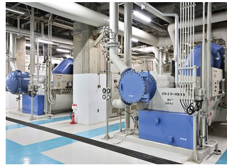
电动涡轮制冷机。这里生产的冷水通过导管供应给用户
