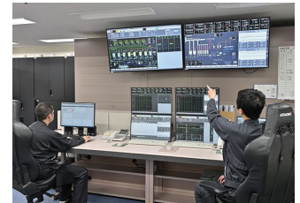
用于监视和控制区域供热装置的Harmonas-DEO。引入了55英寸的大型显示器，不仅可以显示监控画面，还可以在同一屏幕上显示气象信息和监控摄像头的影像等，营造了让所有操作员一眼即可掌握现场状况的环境
