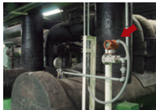
在热源设备的冷水集管上安装的差压压力变送器AT9000 Advanced Transmitter智能变送器Model GTX。测量集管差压，根据负荷端的冷水需求量来调节冷水泵的流量，以实现节能。
