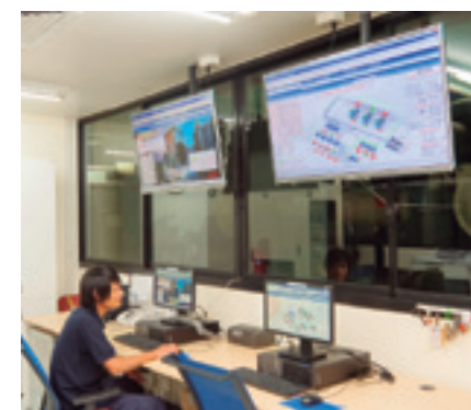
对环己酮生产装置进行集中监视的仪器室。在
