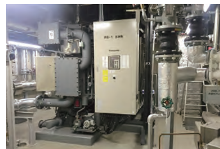
引进了高效率热源机和热源管理用数字控制器 PARAMATRIX TM 4。试图通过最佳运转控制实现大幅节能。
