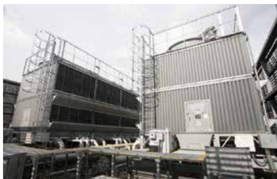
安装在屋顶的冷库用冷却塔。
