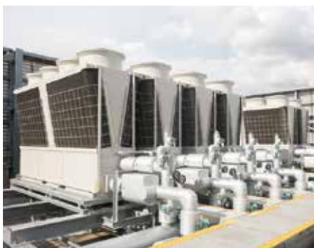
空调用热源机(风冷热泵冷水机)。已单元(冗余)化,即使机器发生故障也可进行备份运转,节能的同时获得极大的安全感。
