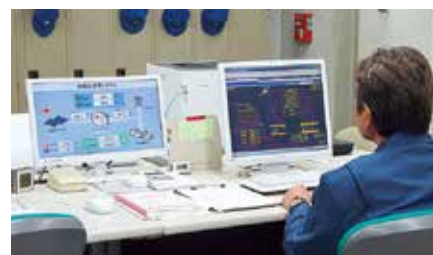
在Life Park Kurashiki的中央监控室中运行的核太阳能发电。除了监控建筑内部设备的运行状况，还可以收集能源使用量等数据。
