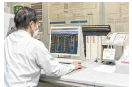
2018年更新的阿自倍尔的楼宇管理系统。对整个设施的运用状况进行统一管理。
