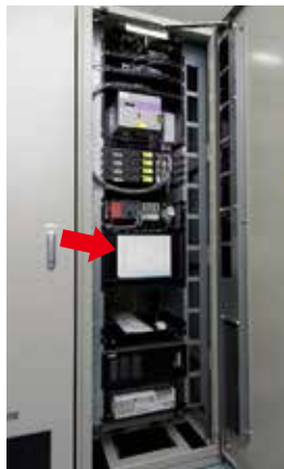
在重要过程变量变化监视系统被引进以前作为管理系统运营的是阿自倍尔的工厂信息管理系统。集中存储各设施的运行数据，包括其他公司监视系统收集的数据。主要用于监视及运行状况分析等工作。
