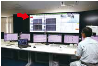
在净水管理中心内的大型显示屏上显示重要过程变量变化监视系统的监视画面，可以随时确认状态。另外，发生异常时，监视器上会显示警报，引起员工注意。
