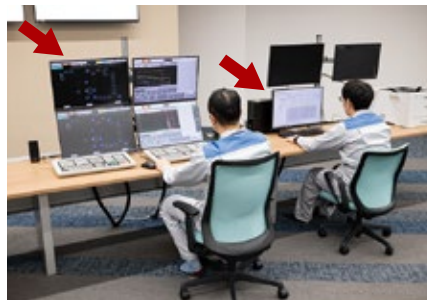
DCS*5として導入されている協調オートメーションシステム Harmonas-DEO(左)とValstaff(右)の監視画面。
