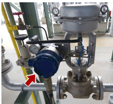
バルブに取り付けられているスマート・バルブ・ポジションとIFOとの間でHART通信を行い現場機器の稼働状況を可視化している。
