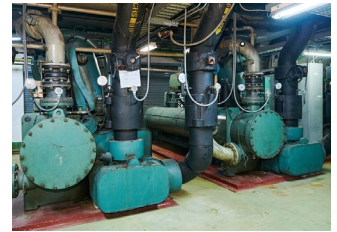
熱源機械室に設置された冷凍機で空調用の冷水を作り出す。BEMSの導入でスケジュールによる発停と台数制御を実施。
