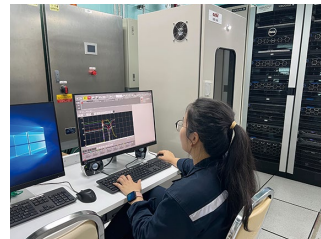
計器室に設置されたアズビルの制御性能最適化設計ツールを操作するエンジニア。既存DCSから収集した運転実績データを確認の様子。
