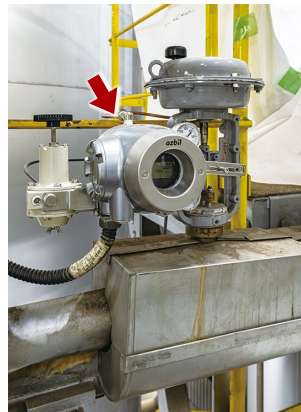
発電用タービンを回すための蒸気に対し、水を投入して温度制御を行う他社製の調節弁に装着されたスマート・バルブ・ポジションナ
