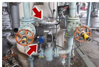
水素精製系に設置された他社調節弁。アズビルのスマート・バルブ・ポジション形 AVP302を取り付けて、調節弁の稼働状態を監視している
