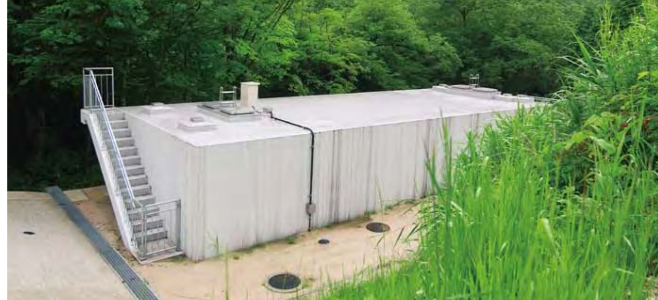
緑と溪流に囲まれた天王浄水場（上斎原地区）の配水槽
