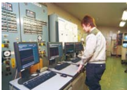
大径管工場の熱処理運転室に設置されたHarmonasの監視・制御用端末。ここでは、鋼管の焼入れ、焼戻しに関する炉内の温度が監視・制御される。
