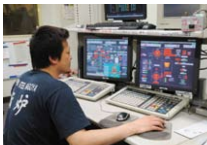
RH真空脱ガス設備の操作室に設置されたHarmonas。真空脱ガスの作業を密着しに見ながら、Harmonasでも制御状況を確認する。
