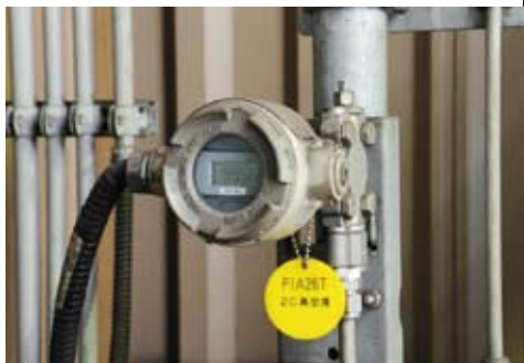
差圧／圧力発信器 DSTJ™3000で真空度を計測する。
