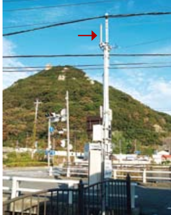
下田地区の数根橋のたもとに立てられた無線アンテナ。橋の下を通る送湯配管に設置された流量計のデータを本社側に無線通信で送信している。
