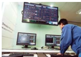
Harmonasの監視端末に加え、事務所にいるメンバー全員で情報共有するために50インチのディスプレイが設置されている。警報発生時には、現場に向いている社員に状況を伝えることができるように、全社員が操作できる体制を整えている。
