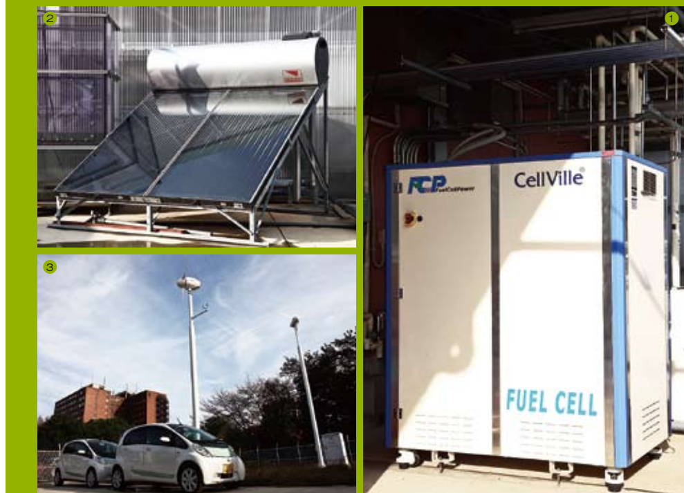
「藻類・エネルギーシステム研究拠点」はほかの自然エネルギーを融合しながら、エネルギーの地産地消、エネルギーのベストミックスを構築する実証実験も実施している。①風力発電と太陽光発電の電気を蓄える蓄電池。②施設の屋上や敷地の各所には太陽光発電パネルを設置。③風力発電機を2基設置。余剰電力は電気自動車にも活用している。
