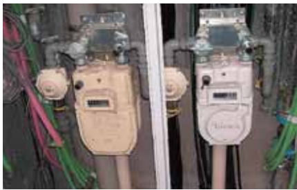
マンションのパイプスペースに設置された従来タイプのNB型マイコンメーター(左)と、新タイプのJB型マイコンメーター(右)。
